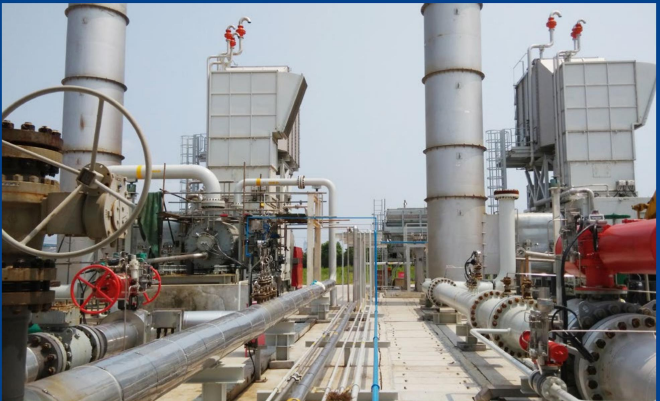
| 燃气动力：广瀚动力中海油宁波黄岩终端燃驱压缩机全貌 |
